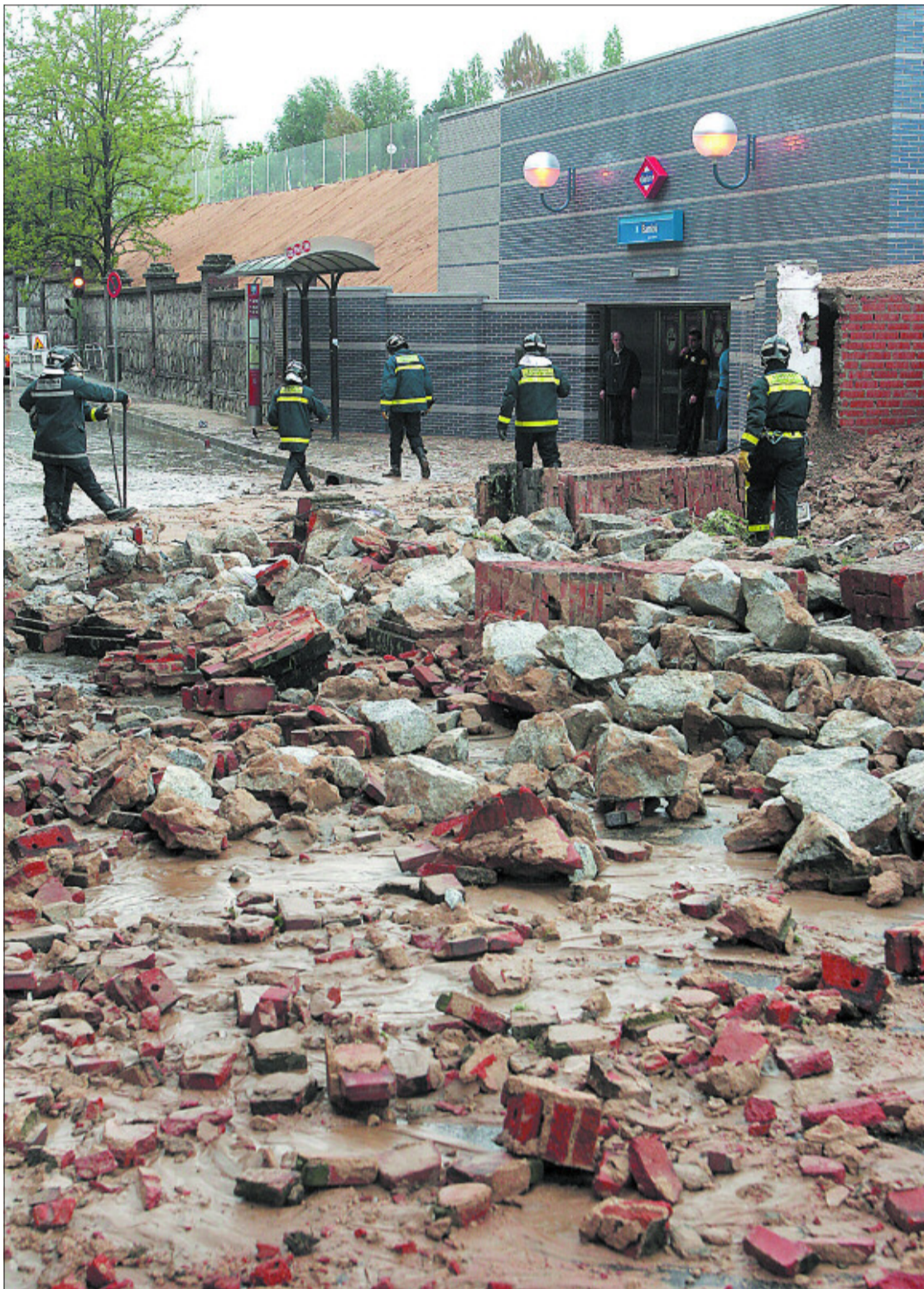
Los bomberos trabajan junto a la estación de metro de Bambú para desescombrar la zona. / GORKA LEJARCEGI
