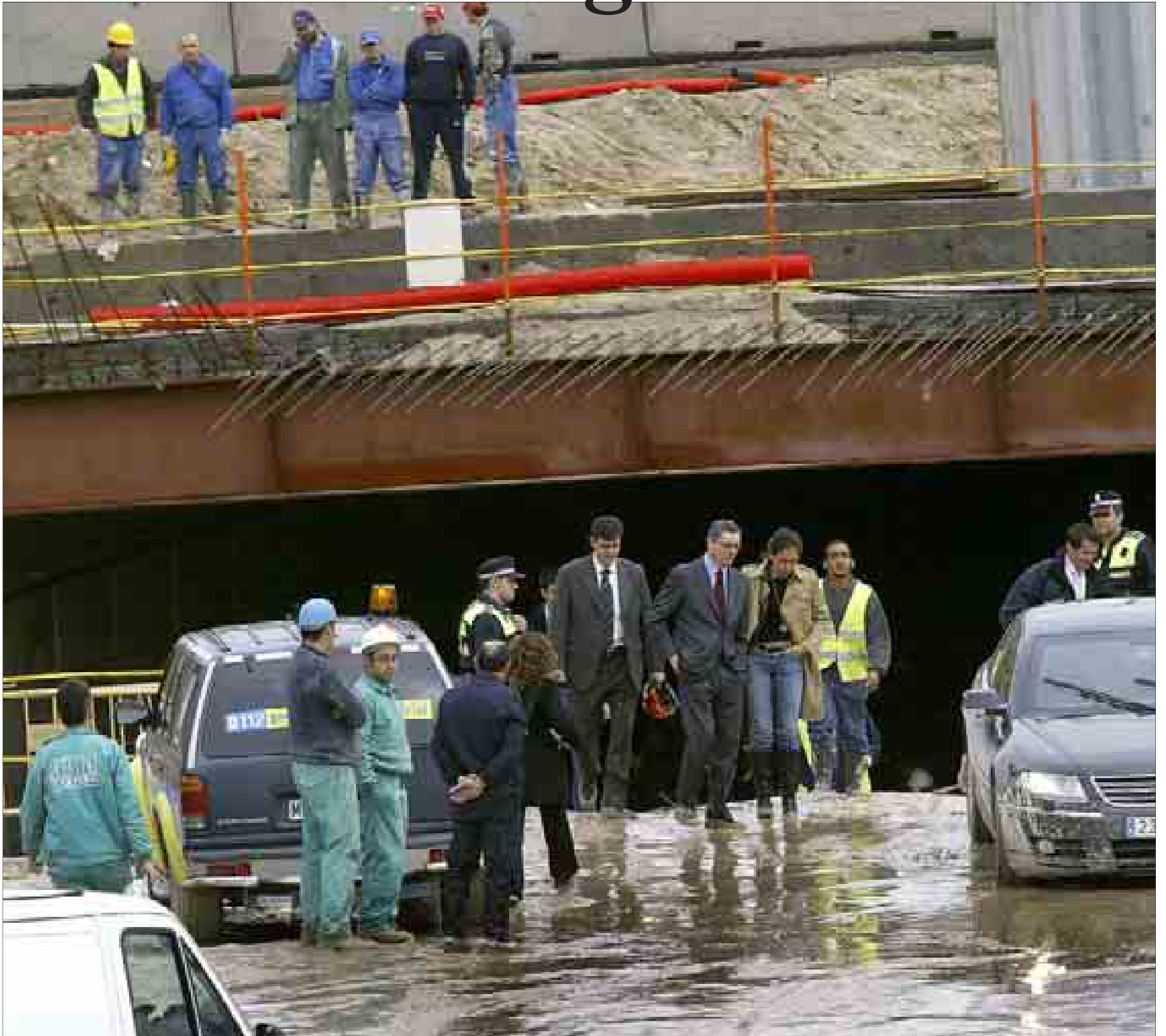
El alcalde, Alberto Ruiz-Gallardón, sale ayer del túnel en construcción en la M-30 Sur donde se produjo el desprendimiento del forjado de hierro que causó heridas a cuatro trabajadores. / JULIO PALOMAR
