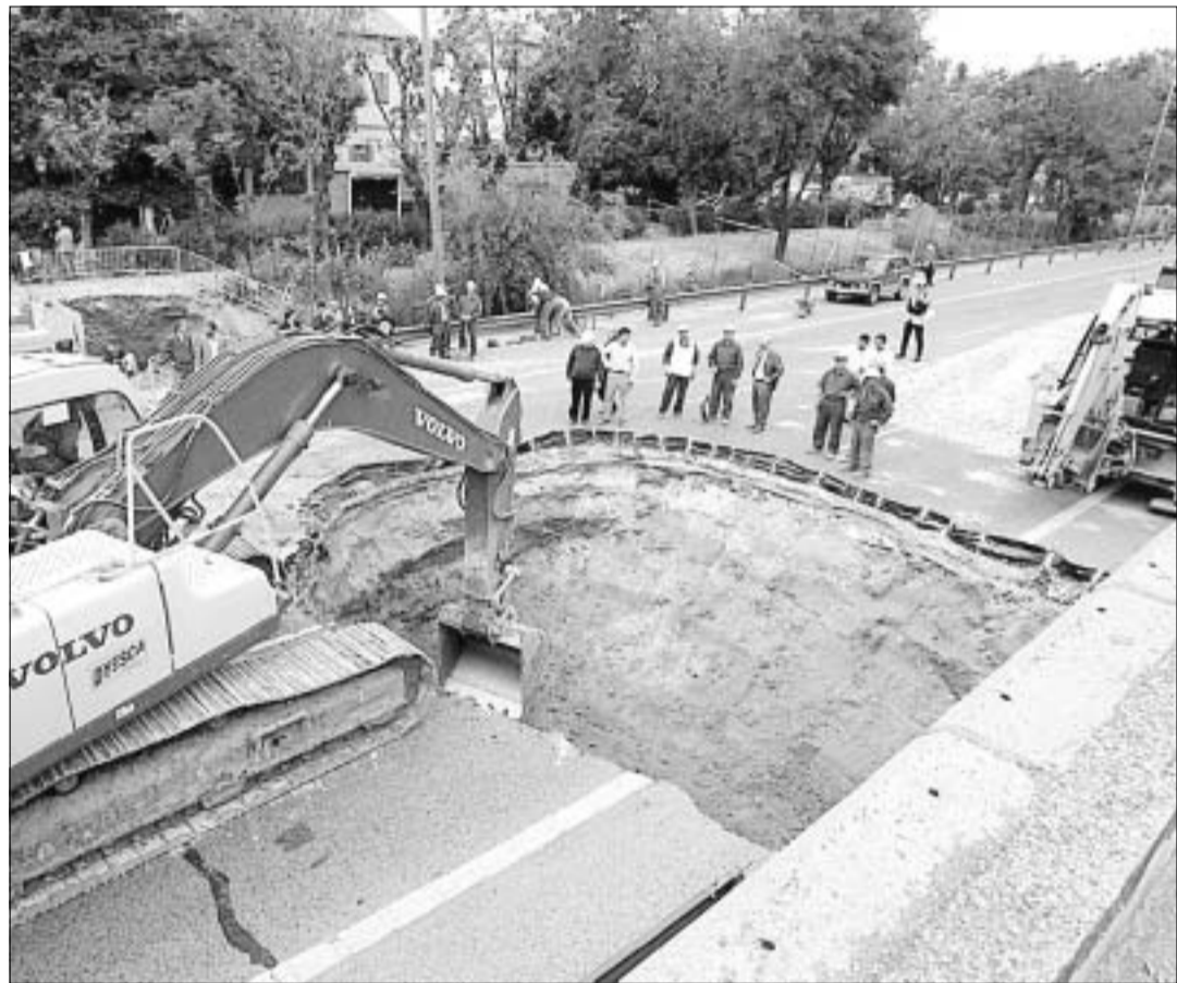
Un socavón en un tramo de la M-30 cercano al túnel de Costa Rica, en abril de 2001. / ULY MARTÍN
